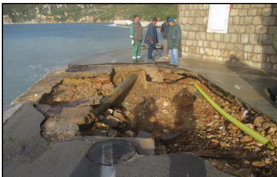
Slika 1.3-5. Uništena kolnička konstrukcija - stanje 31.01.2015.
