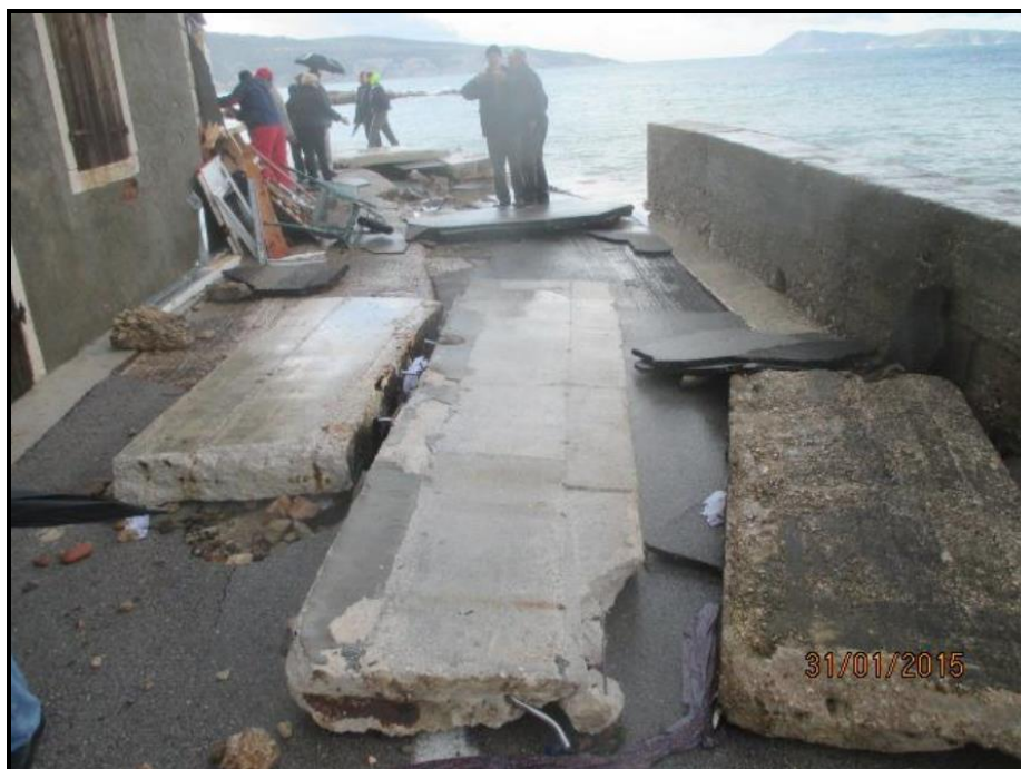
Slika 1.3-4. Porušen parapetni zid i oštećena cesta - stanje 31.01.2015.
